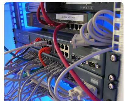
Switch im Rack
