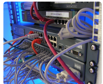
Switch im Rack
