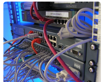
Switch im Rack
