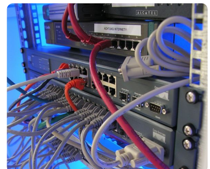
Switch im Rack
