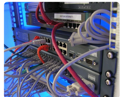
Switch im Rack
